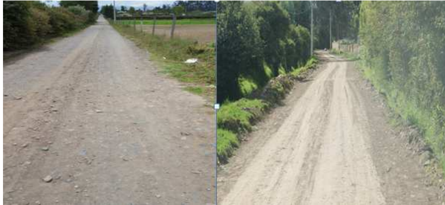
CALLE ALTA TENSION
